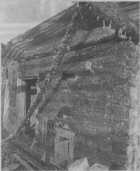
▲ Вот наглядный пример того, как несоблюдение расстояния от топки печи до сгораемых конструкций стены бани (толщина всего одного кирпича) приводит к уничтожению всего дома и имущества. Чудом обошлось без жертв.
