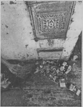
◆ Хлам около печки, отсутствие железного листа – явные нарушения.
