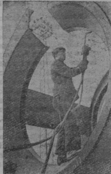
ЛИТОВСКАЯ ССР. На строительстве Литовской ГРЭС начат монтаж первого котла. С вступлением в строй этого гиганта будут электрифицированы все села Советской Литвы.
